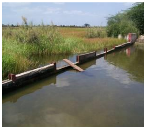
Figure 3 : Ouvrage de régulation de retenue et de lâchées d'eaux à Bakoussas (Diofior)
